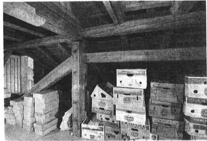
Im «alten» Schulhaus haben sich die Grundpfeiler gesenkt.
